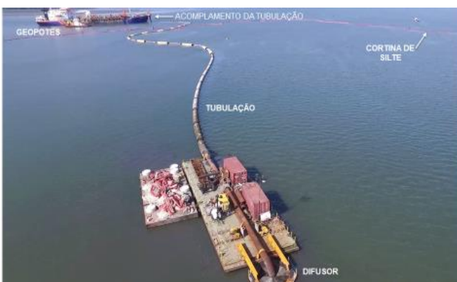
Figura 7 - Operação de disposição de material Dragado na CAD. Em primeiro plano Difusor para deposição
